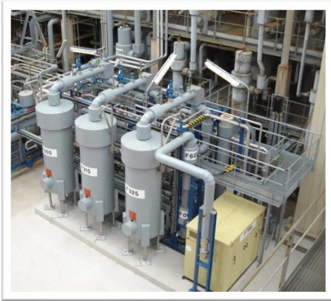
VF2 dryer 1800 Nm 3 /h - 2,5 Barg
